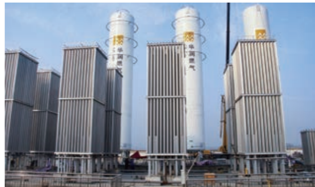
南阳茶庵建成LNG储配站
