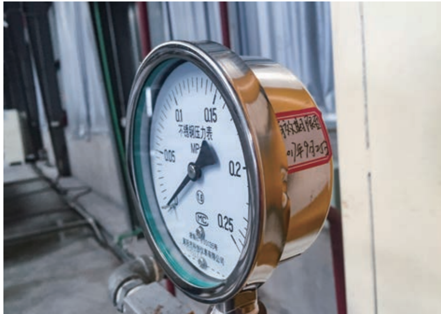
安全装置有效期检查
