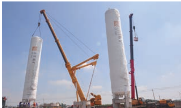
江宁公司投资建设上湖LNG储配站
